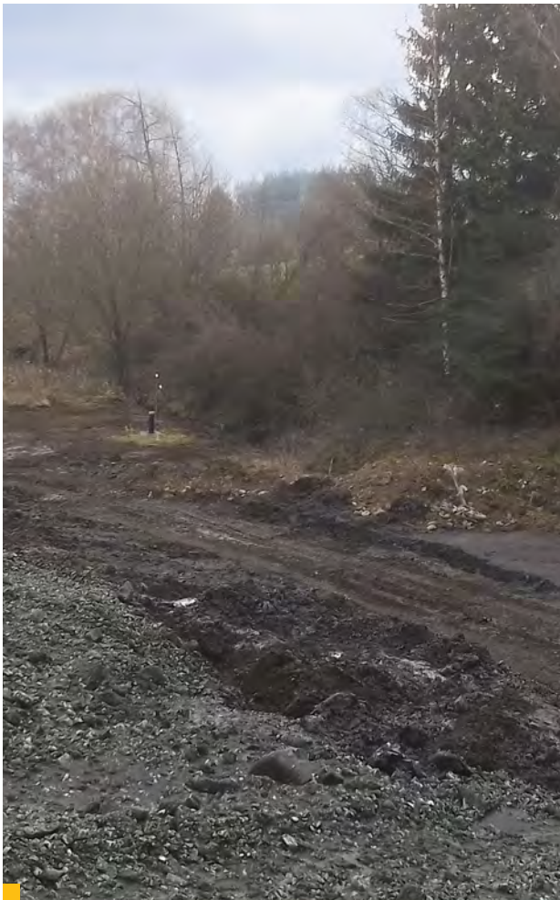
4 Skládka Široká – zeminou provizórne prehradený obvodový rigol
