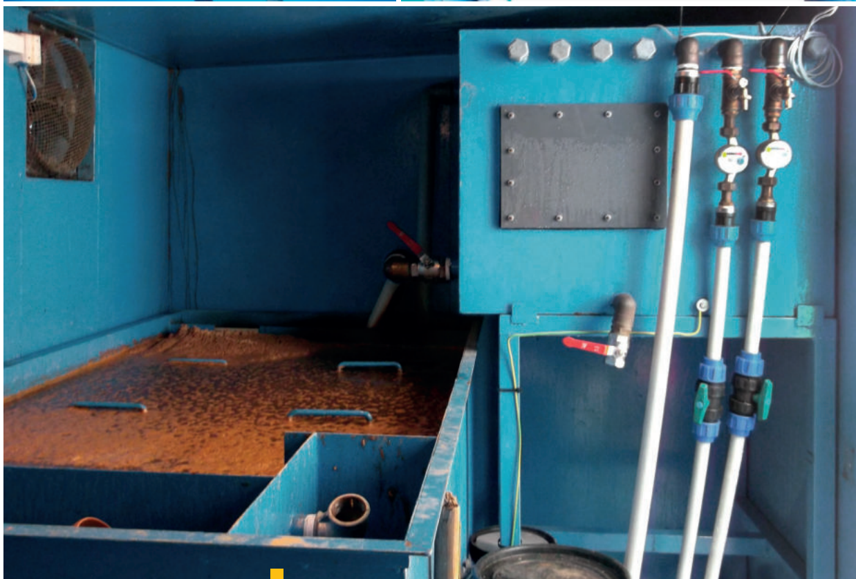
9 | 10 | 11 Interiér sanačnej stanice | zdroj: MŽP SR
