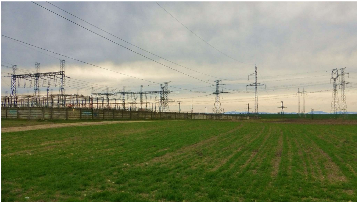
Lokalita ESt Križovany, k.ú. Križovany nad Dudváhom, Zavar, 3-2026. Pohľad na zaústovacie úsek vedenia V279 pozdĺž severného a západného okraja elektrickej stanice s podkrižovaním 400 kV vedení.
