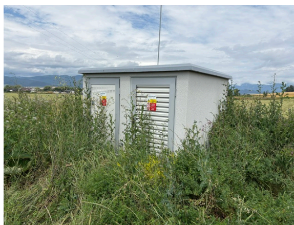
Foto. 6 – Pohľad na kioskovú trafostanicu v priestore plánovanej obytnej zóny
