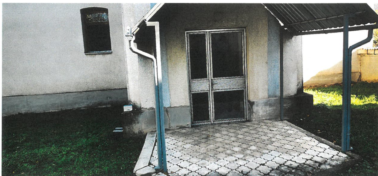
Obr. 3 Meracie stanovisko S3, situovanie meracej aparatury ABEM Vibratloc na betónovom základe objektu kostola vo Včelároch vo vzdialenosti 1394 m od odstrelu č. 5083 v lome Včeláre
