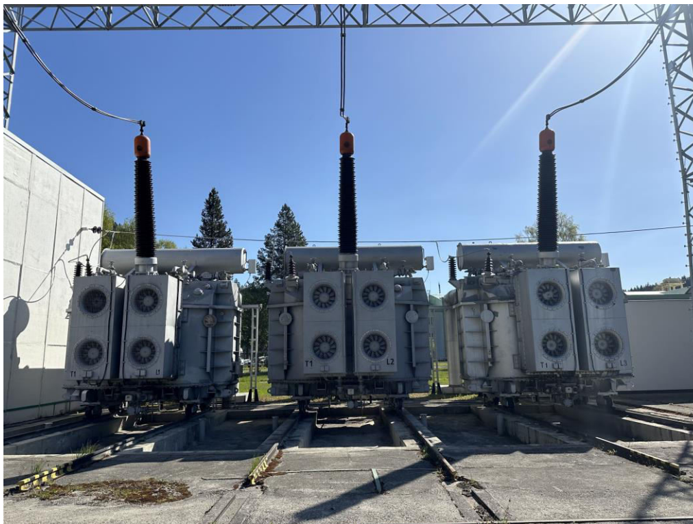
Obr. 5 Pohľad na tri jednofázové jednotky transformátora T1
