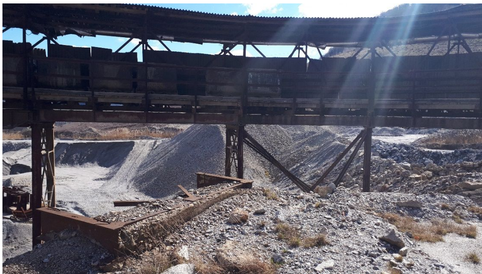
Foto č. 2: Povrchová doprava vozíkovým obehom
