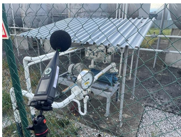
FOT. 9 Pohľad na čerpadlo
