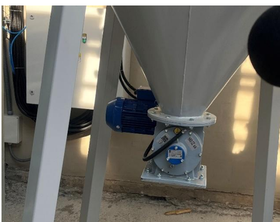
FOT. 10 Pohľad na čerpadlo
