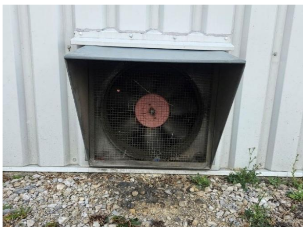
FOT. 3 Výdych vzduchu na fasáde
