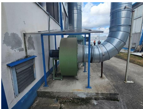
FOT. 7 Pohľad na čerpadlo
