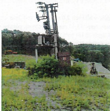
Foto 2: Naklonenie transformátorového stĺpa v areáli prevádzky LOMY SV, s.r.o.
