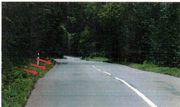
Foto 1: Zvltný profil cestného telesa, pozíčne pod areálom LOMY SV, s.r.o
