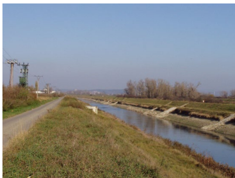
Foto. č. 1 Fotodokumentácia porúch svahov odpadového kanála
