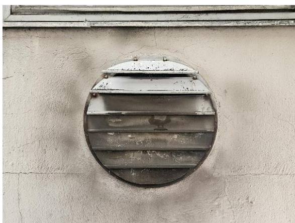
FOT. 1 Výdych vzduchu na fasáde
