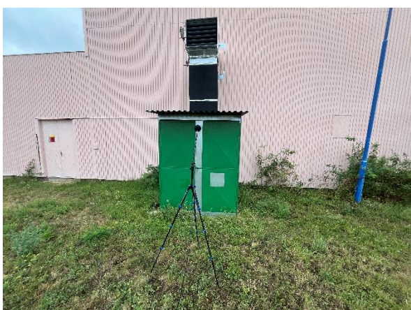
FOT. 6 Výdych vzduchu na fasáde
