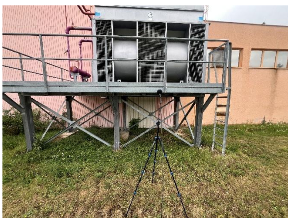
FOT. 5 Vzduchotechnická jednotka
