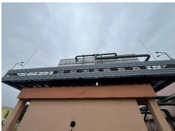
FOT. 4 Vzduchotechnická jednotka
