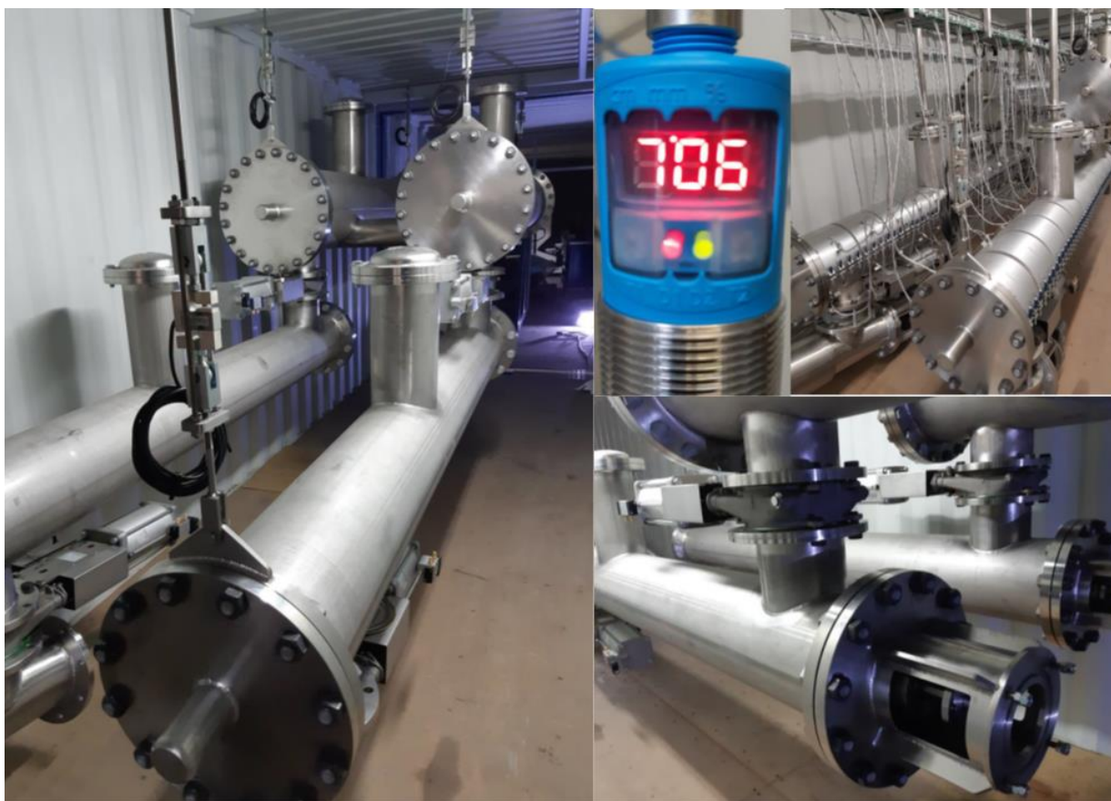
Obr. 3 Posudzované zariadenie – detaily vybraných technologických častí
