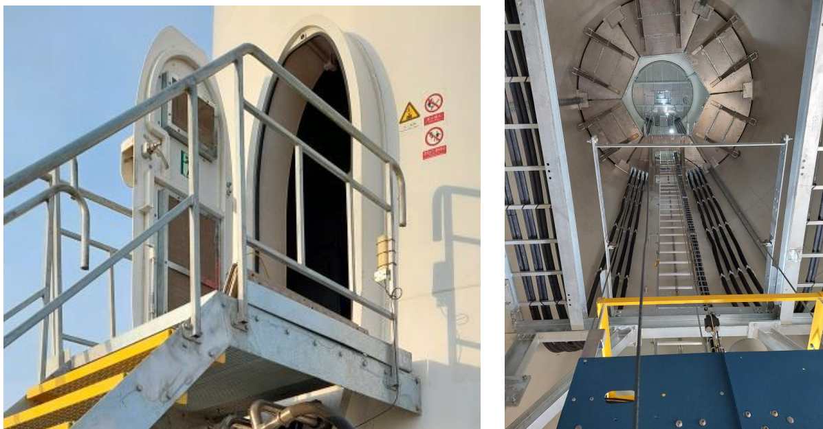
Obr. č. 5: Vstupné dvere do veže (vľavo) a pohľad do vnútra veže zospodu (vpravo)
