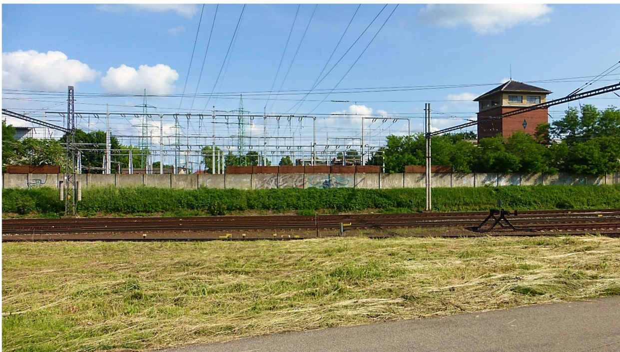
Lokalita žst. Trnava, k.ú. Trnava, 6-2025. Pohľad na elektrickú stanicu Trnava - centrum, kde bude po križovaní železničnej trate č.120 (v popredí) zaústené nové 2x110 kV vedenie 8831/8896 (A9 - SO 01.1).
