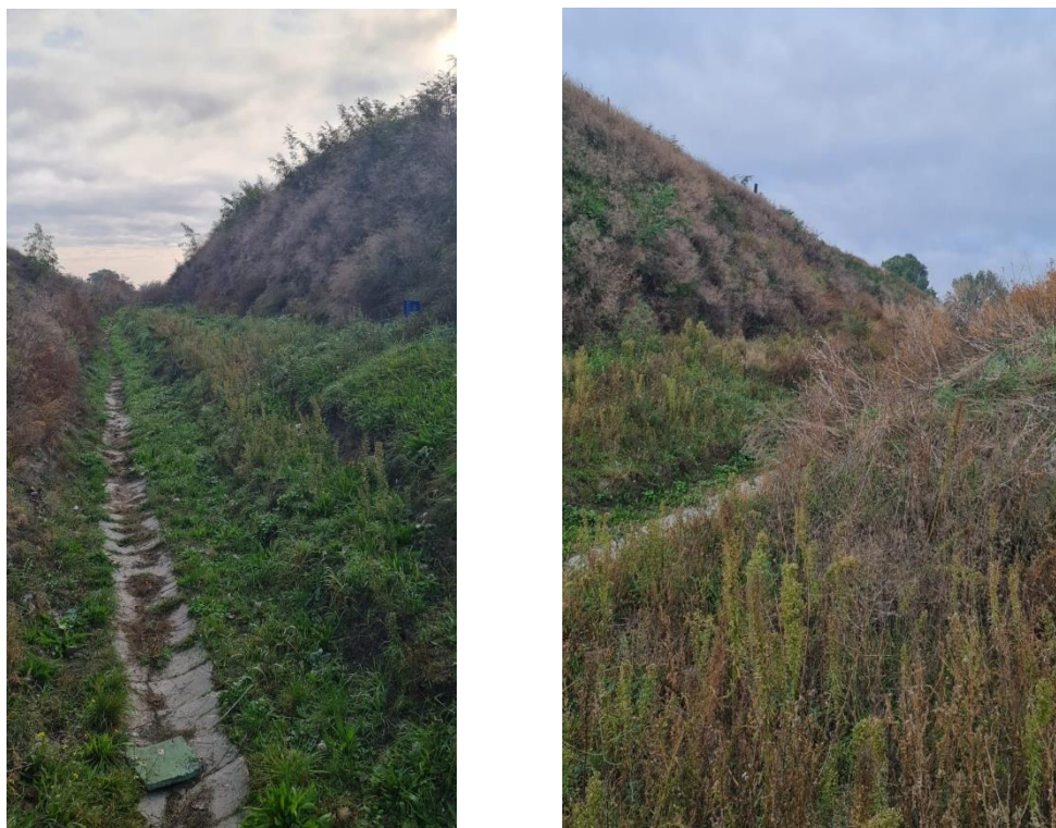
Obrázok č. 3: Nevyhovujúci nestabilný sklon svahov Skládky odpadov
