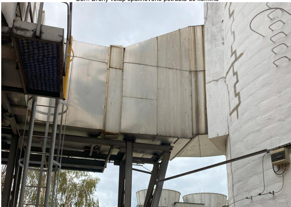
Obr.: Druhý vstup spalínového potrubia do komína
