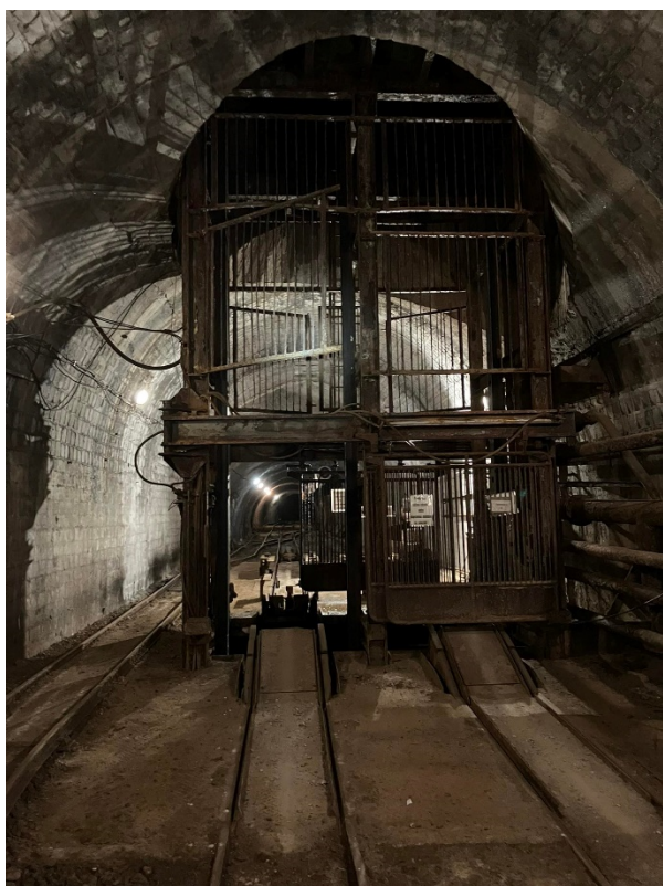
Foto č. 10: Nárazisko – v podzemí
