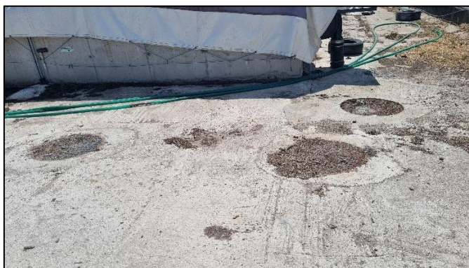
Akumulačná nádrž AN2 pri kóji 1 (25m 3 )
