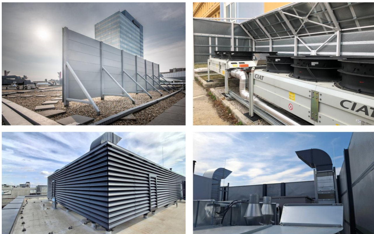
Obrázok 36 Referenčné realizácie protihlukových bariér z protihlukových panelov AkuSystem P-53 ( www.akusystem.sk )
