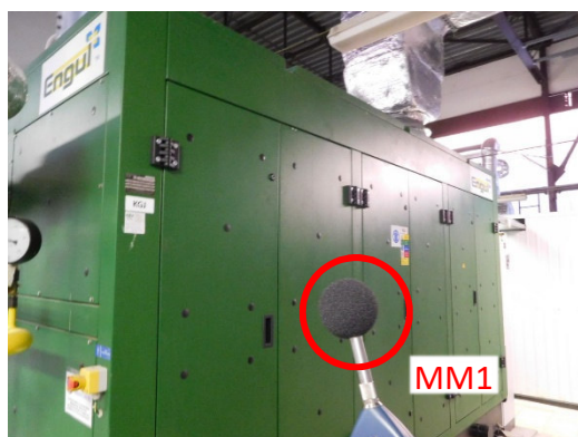
Obr. 9 Situovanie miesta merania pri KGJ vo vnútri budovy kotolne
