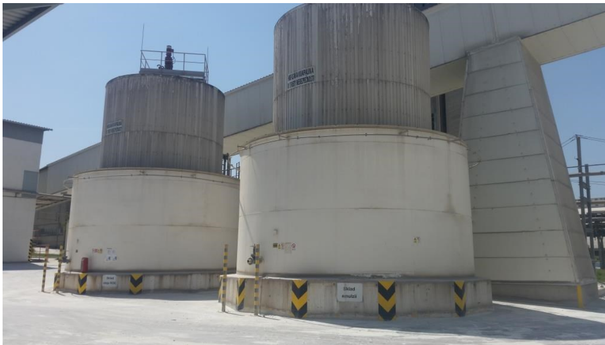
Obrázok č. 2: Skladové zásobníky odpadových olejov
