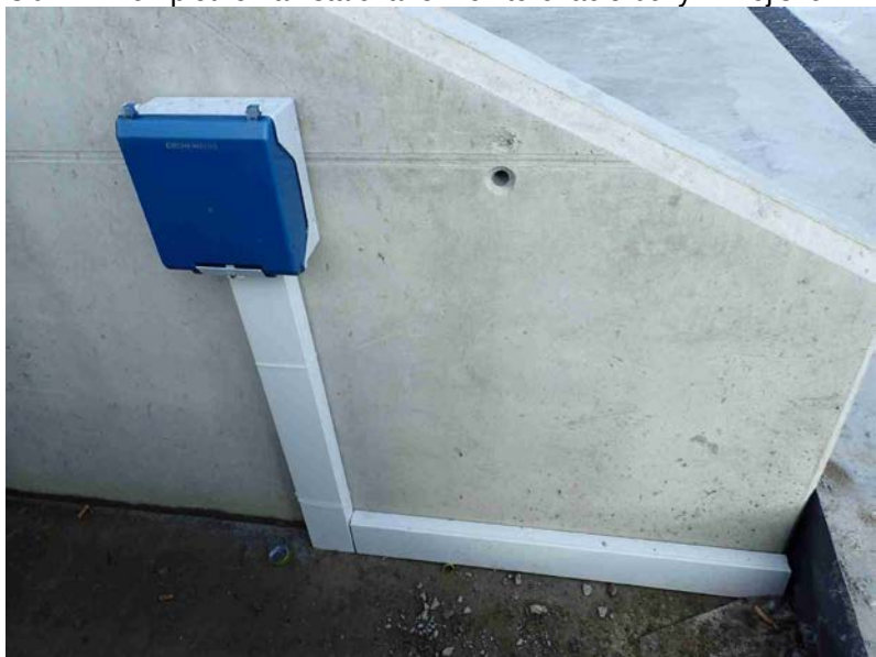
Obr.11: Kompletne nainštalované monitorovacie boxy - hnojisko
