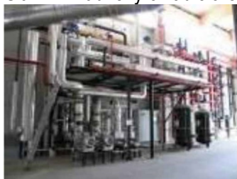
Obr.12: Núdzový chladič a obehové čerpadlo
