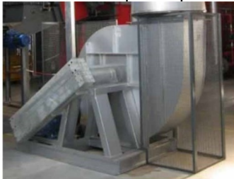
Obr.8: Odtáh spalín spalinovým ventilátorom
