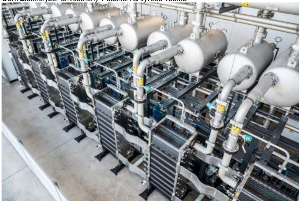
Obr.: Elektrolyzér umiestnený v stanici na výrobu vodíka
