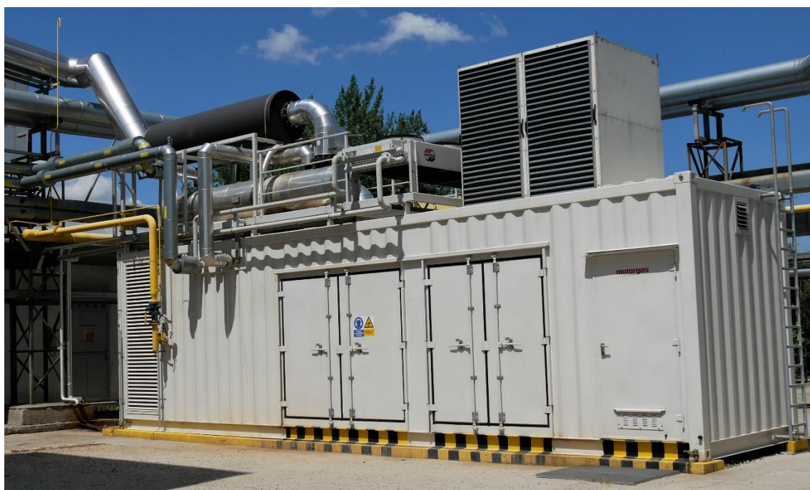
Obr. 3 kogeneračná jednotka NTS Nitra, CTZ Párovce
