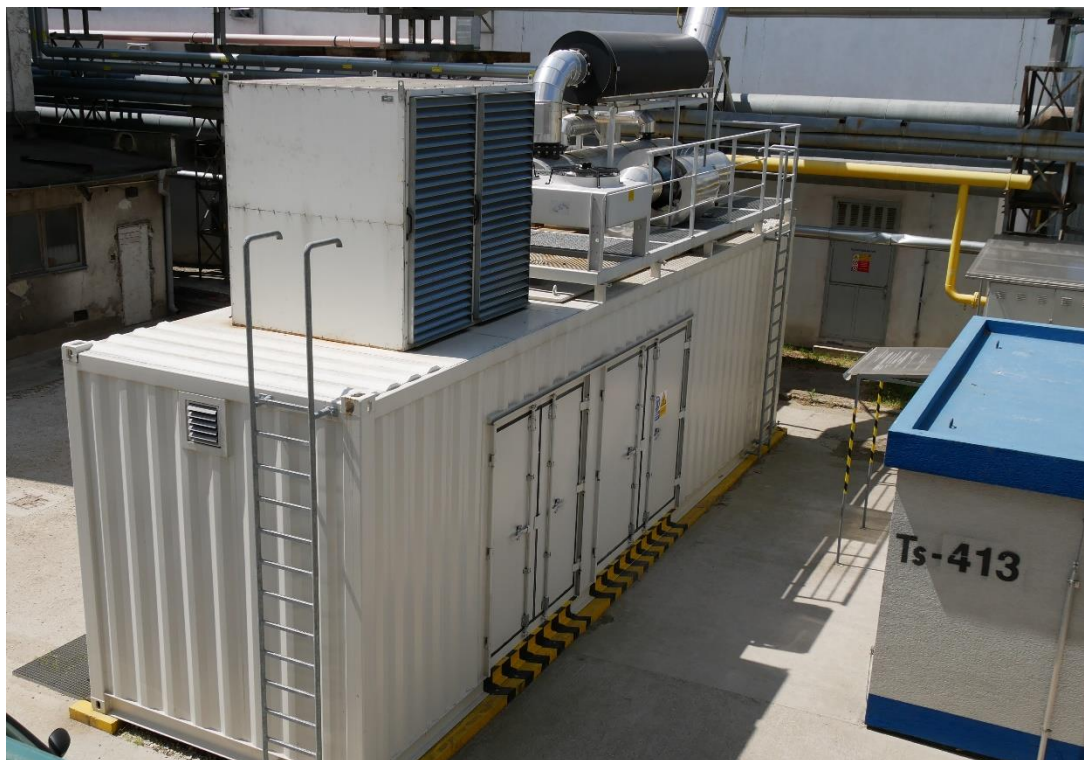
Obr. 4 Kogeneračná jednotka NTS Nitra, CTZ Párovce
