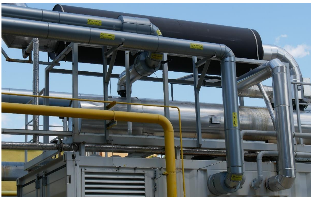
Obr. 5 Kogeneračná jednotka NTS Nitra, CTZ Párovce
