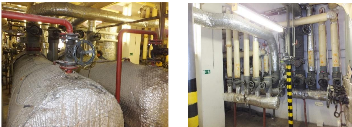
Obr. 11 Odovzdávacia stanica tepla - OST 8 – M.R. Štefánika 149
