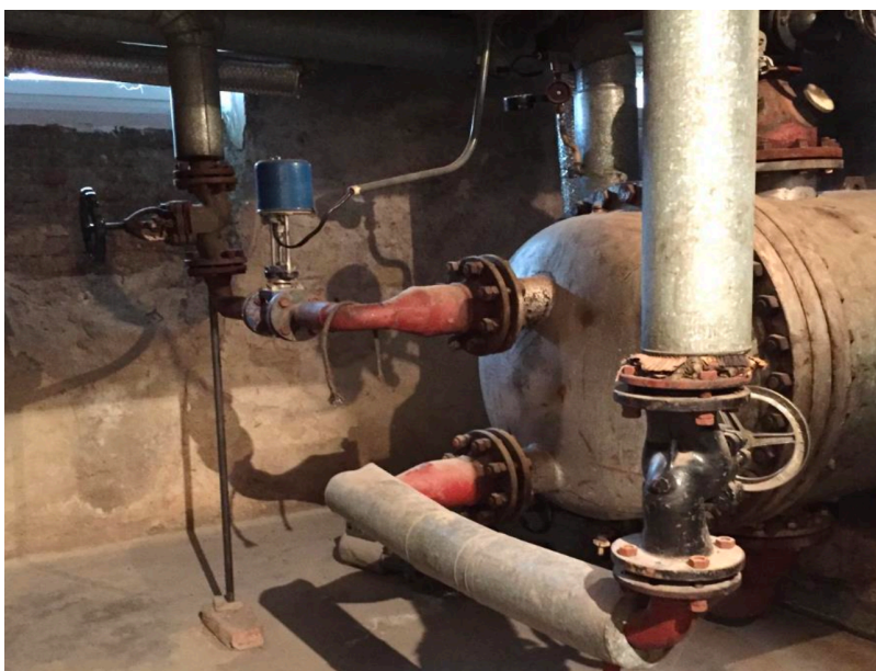
Obrázok 8 Trubkový výmenník tepla a chýbajúca izolácia na tepelnom zariadení
