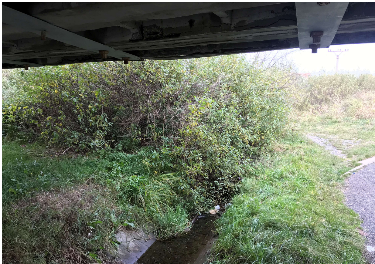
Obrázok 1: Stav toku Potôčky a biotopov pod mostom I/18-389A a na výtokovej časti mosta
