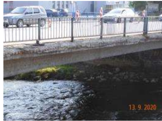
Zlý technický stav mosta ev.č.66-064
