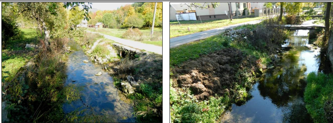
Foto 7 a 8: Stredný úsek protipovodňovej úpravy na Bebrave v Krásnej Vsi so svojpomocnými protipovodňovými múrikmi a skládkami odpadu zo záhrad, ktoré zanášajú tok.
