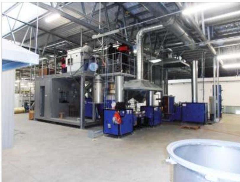
Obr. č.5 - Technologické zariadenie z existujúcej prevádzky firmy EKO HYBRES Sp. z o. o. Rzeszów v Rogoźnici
