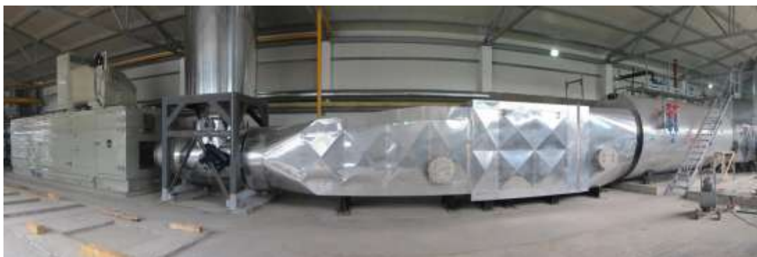
obr.č.10 Plynová kombinovaná turbína CHP s OP16 - zariadenie vyrába holandská spoločnosť OPRA - referencie na webovom sídle www.opraturbines.com
