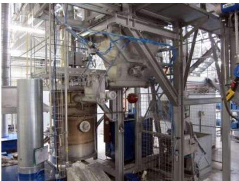
Obr. č.6 Technologické zariadenie z existujúcej prevádzky firmy EKO HYBRES Sp. z o. o. Rzeszów v Rogoźnici
