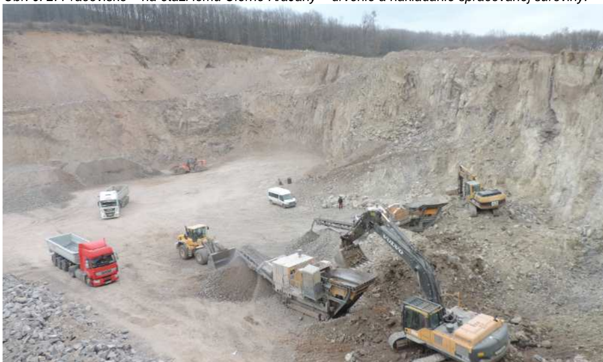
Obr. č. 2: Pracovisko – na etáži lomu Čierne Kľačany – drvenie a nakladanie spracovanej suroviny.
